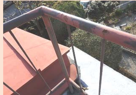
例) フェンスの腐食
