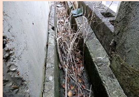
例) 側溝の詰り
