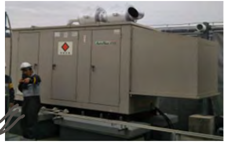
非常用発電機
