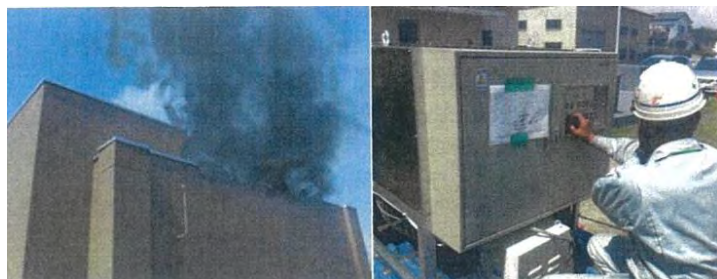
(某浄水場70%負荷20分後の黒煙で点検を一旦中止する)
