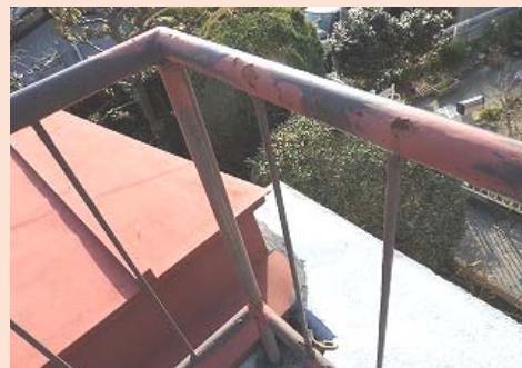
例) フェンスの腐食
