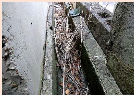
例) 側溝の詰り
